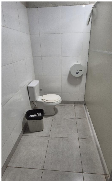
Figura 9: Baños para Discapacitados. Nota. Imagen de Elaboración Propia. El baño para discapacitados no cuenta con una barandilla.
