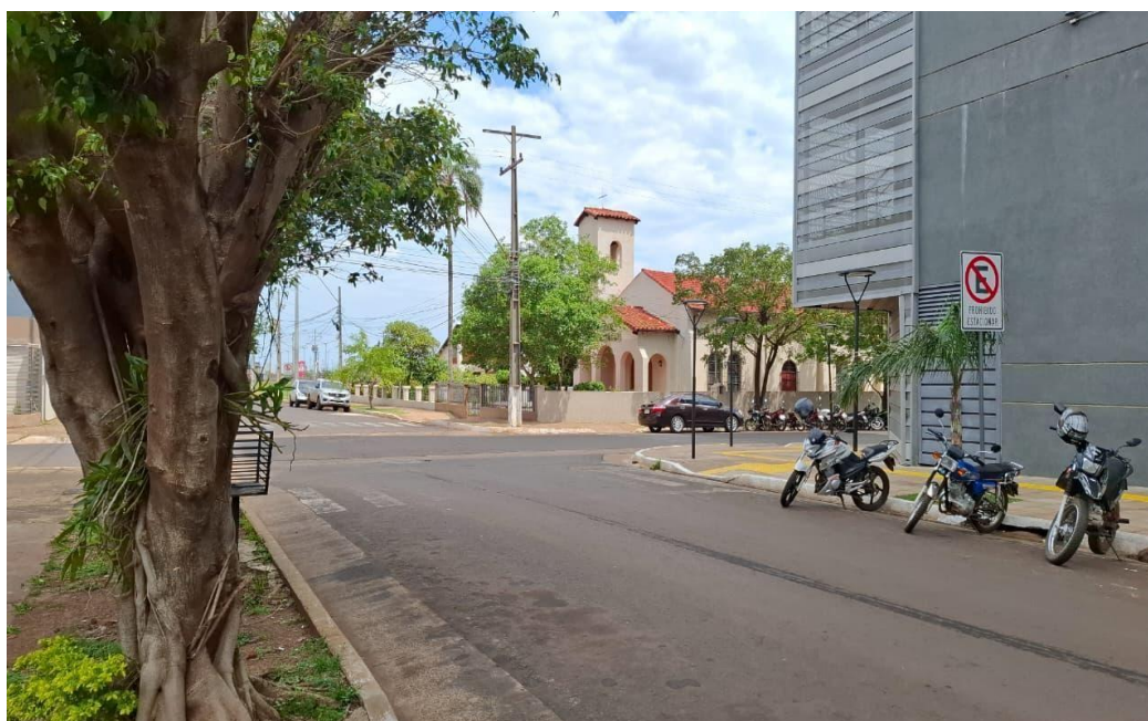
Figura 6: Paso peatonal desgastado. Nota. Imagen de Elaboración Propia.
