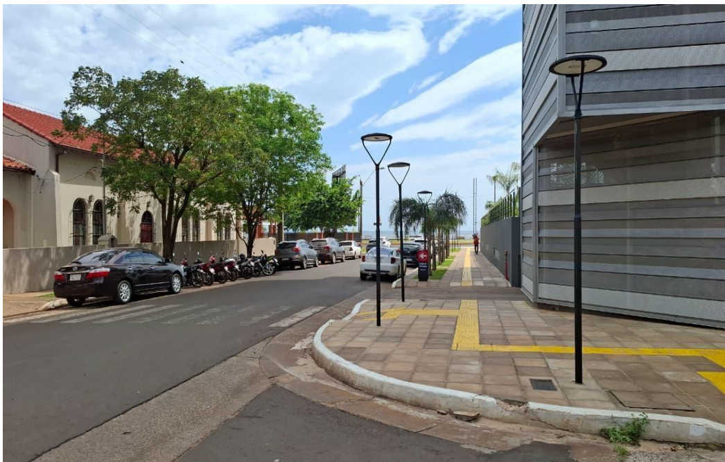
Figura 5: Cordones deteriorados en esquinas. Nota. Imagen de Elaboración Propia.
