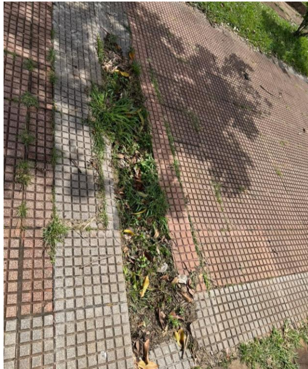
Imagen 5: vegetación invasora que ha provocado deterioro y grietas en la infraestructura urbana de la acera. Nota: Imagen de elaboración propia
