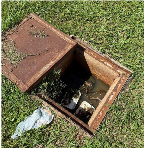
Imagen 8: Drenajes obstruidos por acumulación de residuos sólidos. Nota: Imagen de elaboración propia.
